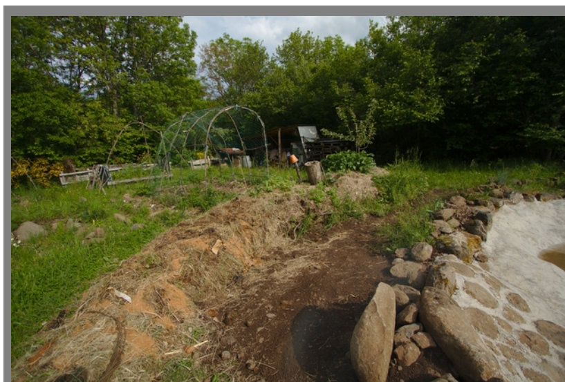
Illustration 11: On commence par un côté et on avance ce qui forme au fur et à mesure une butte de longueur variable.
